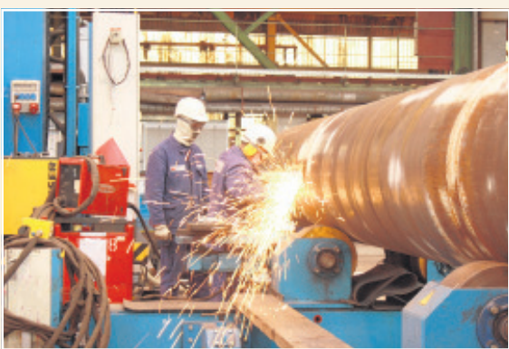
Noch nicht ganz vorbei: Arbeiter von Weserwind schweißen an einer der letzten Komponenten für den Windpark Global Tech 1. Was danach kommt, ist ungewiss.
