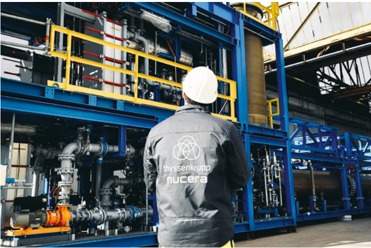
Wasserstoffanlage von Thysssenkrupp Nucera: Die EU lässt endlich Gelder fließen
